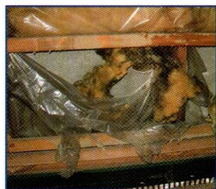
経年劣化したグラスウールの断熱材
