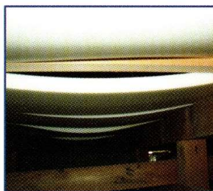
重みで沈み隙間のできた床下の断熱材
